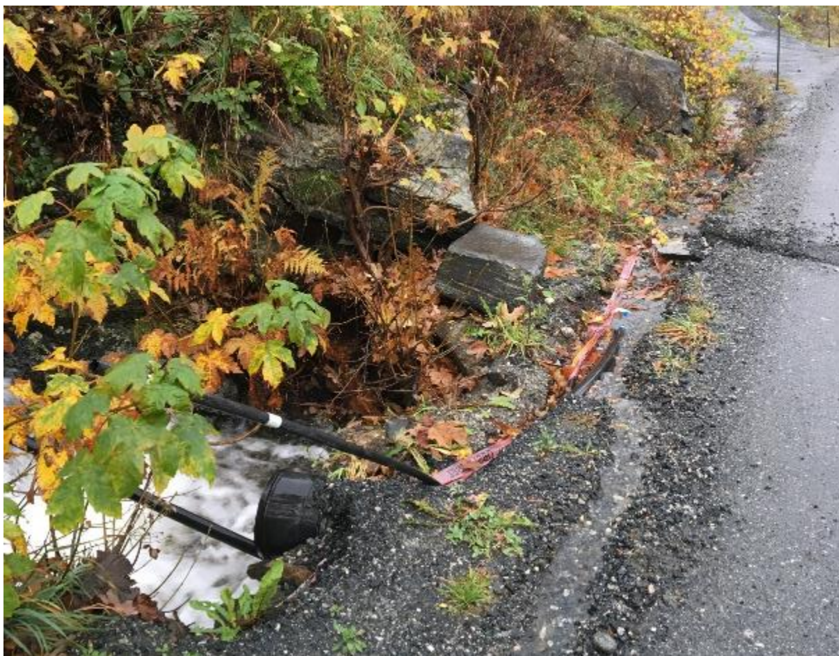
Figur 5-14 Utvasking av veien ved innløp av stikkrenner.
