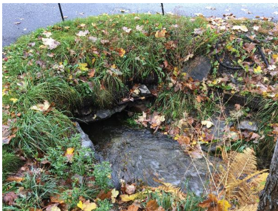
Figur 5-10 Innløp av stikkrenne
