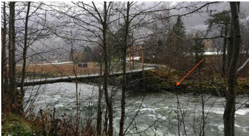
Figur 5-1 Berdalsbrua. Forbygning som er utsatt for erosjon er vist med rød pil.
