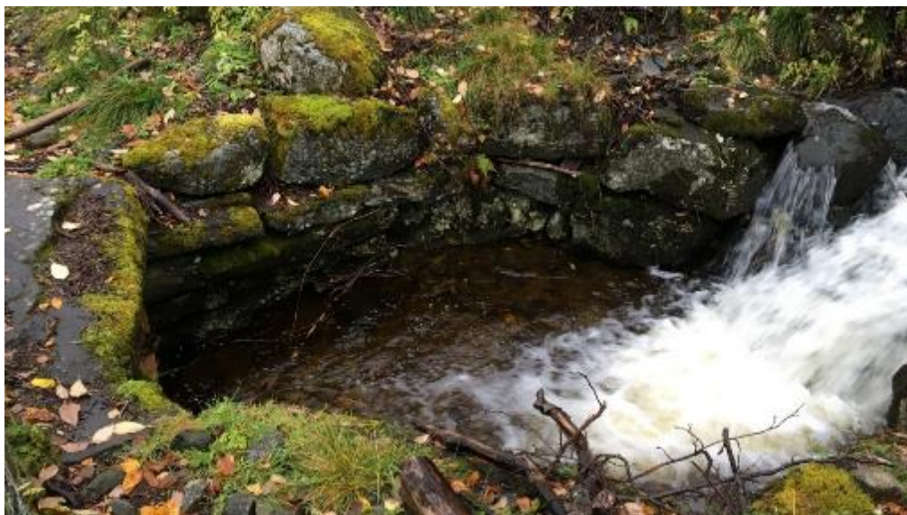
Figur 5-23 Innløp av stikkrenne ved Hjelle/Dalen (pkt 11).
