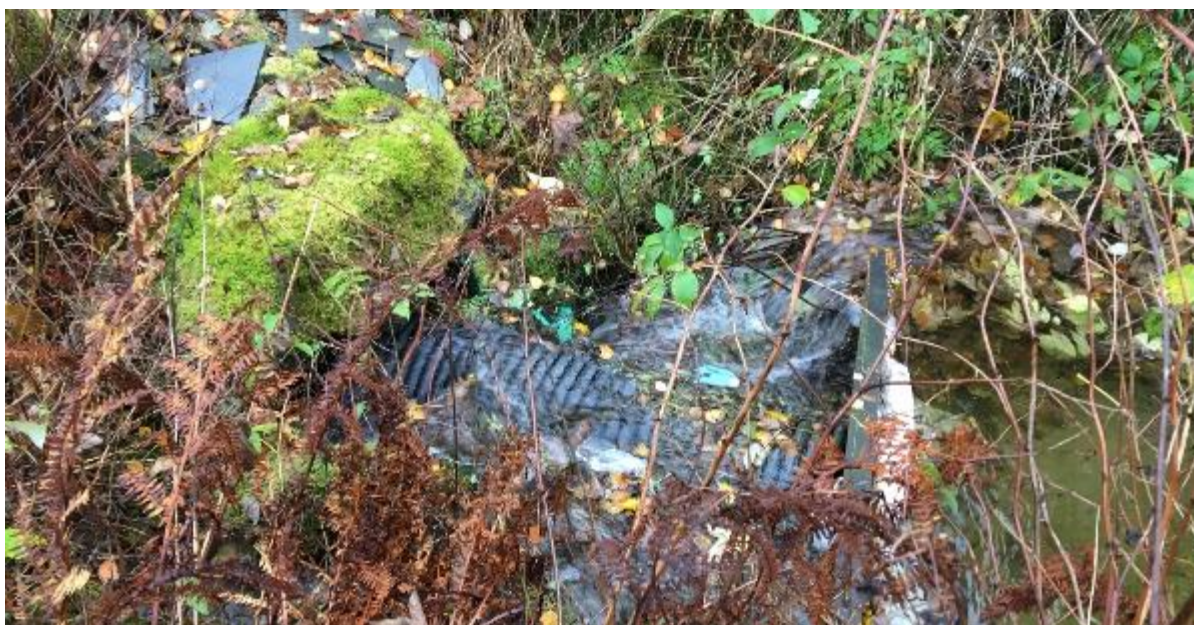
Figur 5-30 Innløp av stikkrenne ved Fagervollan. Rist foran innløp er tettet igjen av plast.
