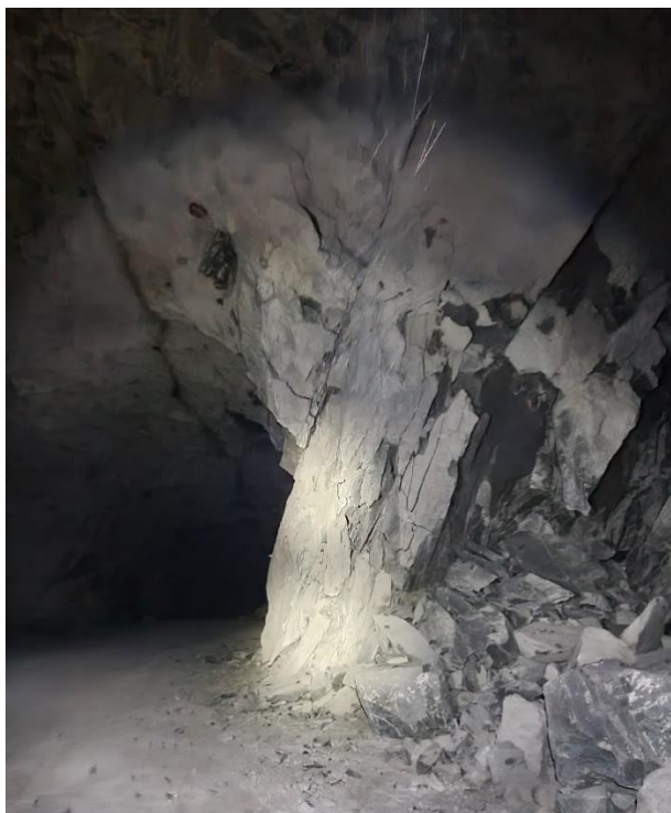
Figur 14: Stresset pilar mellom tverrslag i linse 2, nivå +20. Avskallinger har ført til at øvre del av pilaren er uten fot. Bildet er tatt mot (vest).
