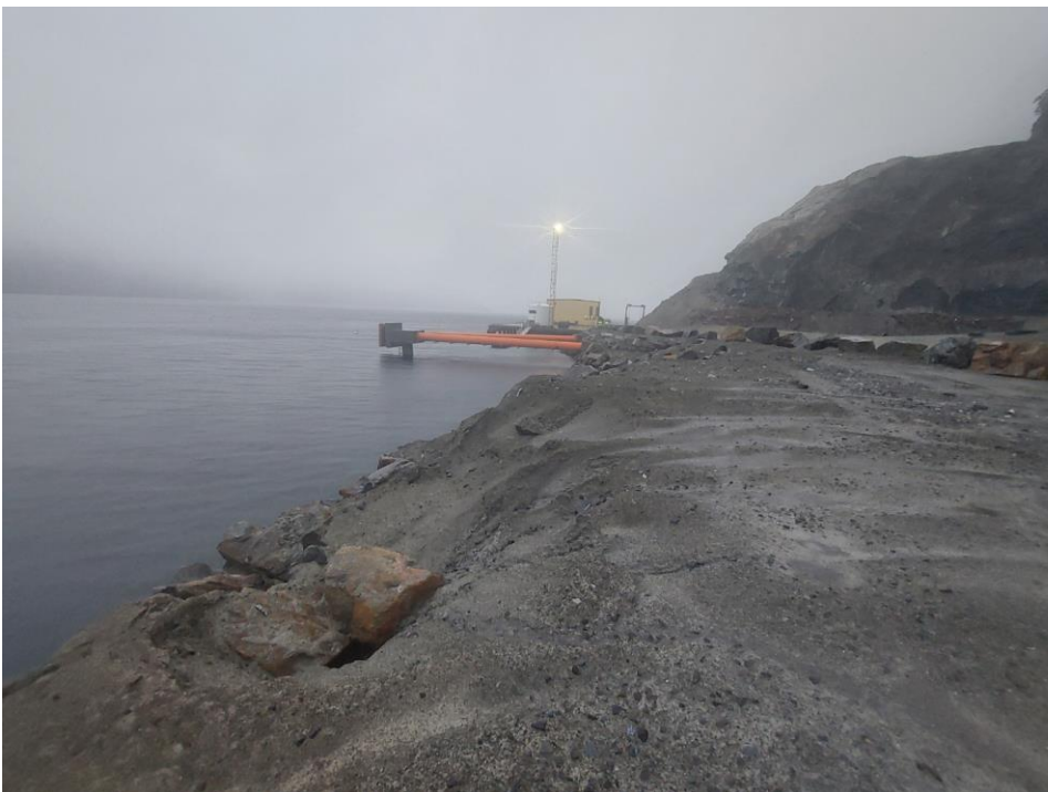
Figur 4: Område med nyere utfylte masser med ikke konsoliderte masser og tegn til setninger og pågående erosjon.
